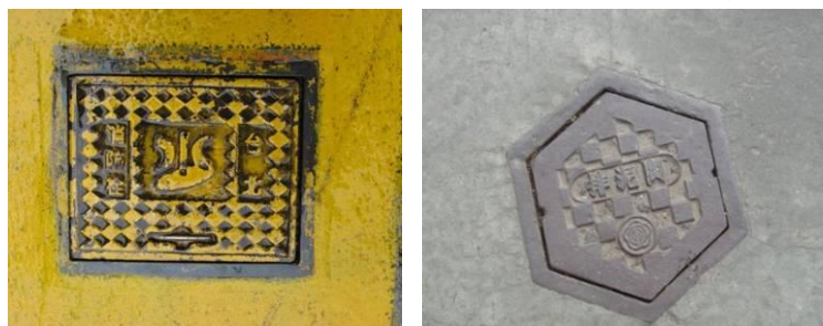
圖 1-5 公用管線孔蓋之消防栓（左）及排泥閘（右）
