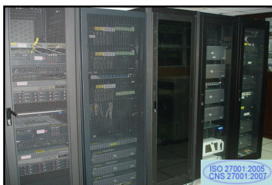
圖 4 e-GPS 控制及計算中心機房內景
